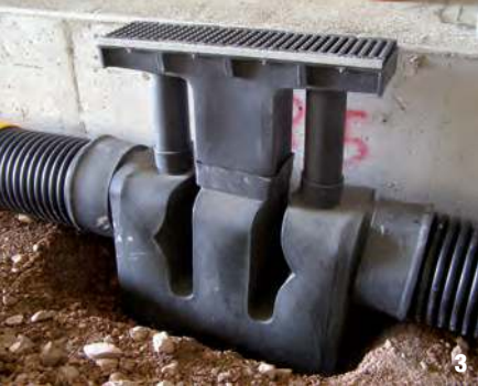
1. Canaletta "tagliafuoco" nella galleria Scacciano (A14)
