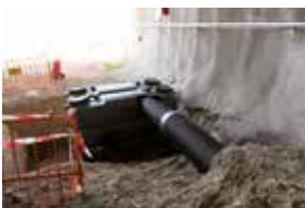
monitoraggio sistema di raccolta acque
