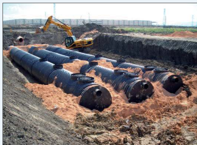
Figura 4 - Un impianto di separazione di sabbie e di liquidi leggeri portata a trattamento 600 l/s, formato da SGK ID2000. Foggia (2009)
