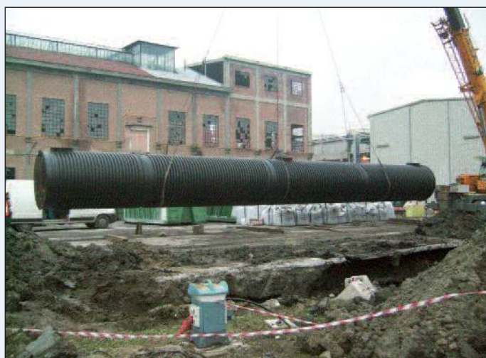
Figura 2 - Il serbatoio di accumulo per acque di prima pioggia da 70 m 3 formato da SGK ID2000: Ravenna (2008)
