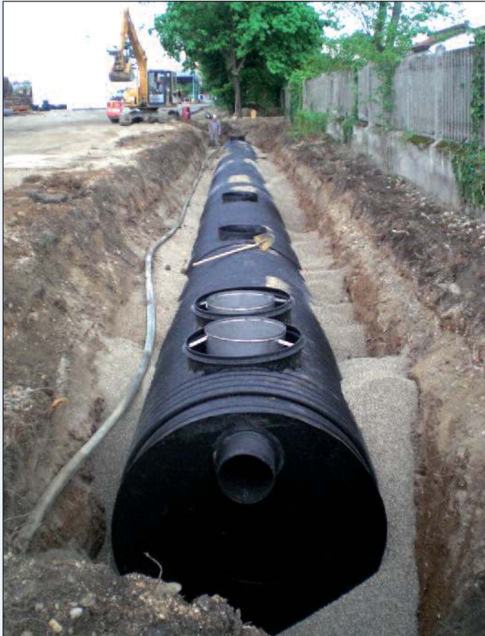
Figura 5 - Un impianto di separazione di sabbie e di liquidi leggeri OSS200Is. Udine (2009)
